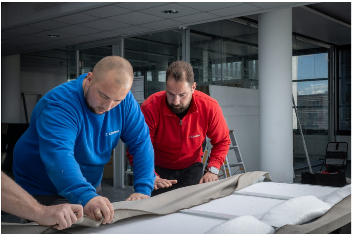
Abbildung 12: Metallabsorber werden mit neuem Stoff bespannt. Projektbeispiel: Lindner Wandabsorber, © Lindner Group
