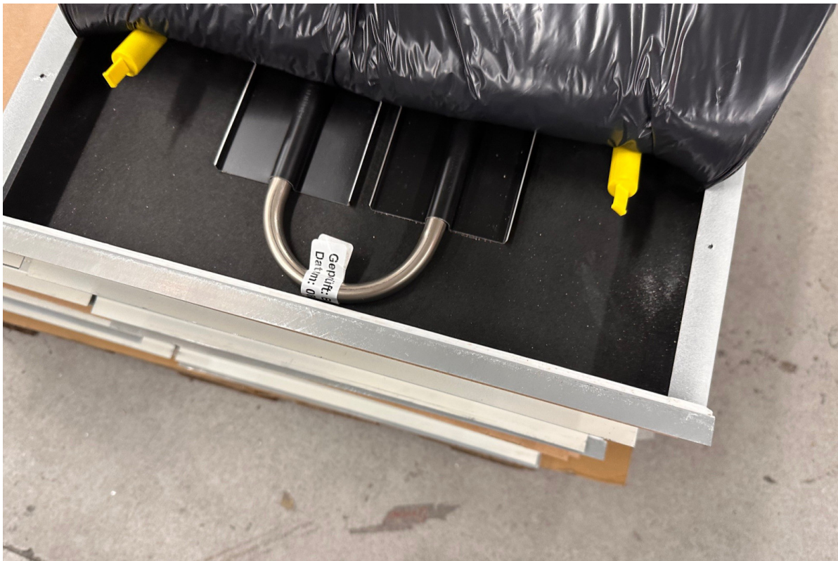
Abbildung 11.1: Nachrüstung Heiz-Kühltechnik. Projektbeispiel: Europäisches Patentamt München, Dietrich Untertrifaller Architekten ZT GmbH, © Lindner Group
