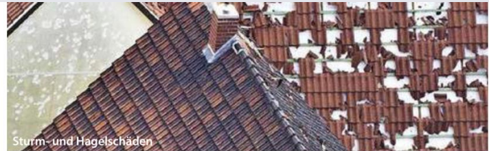
Sturm- und Hagelschäden
